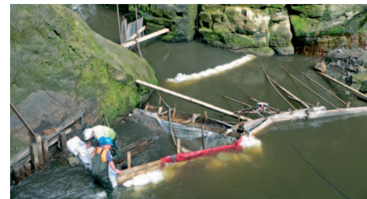
Poškození a obnova jezu po povodni roku 2010. Foto: Miloš Trýzna
